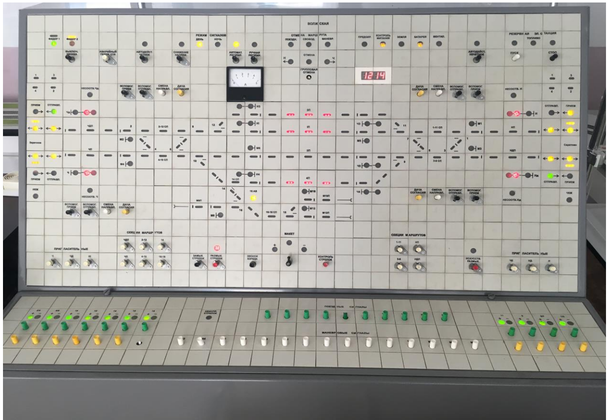
Рис. 3 Внешний вид аппарата железнодорожной станции Волжская
